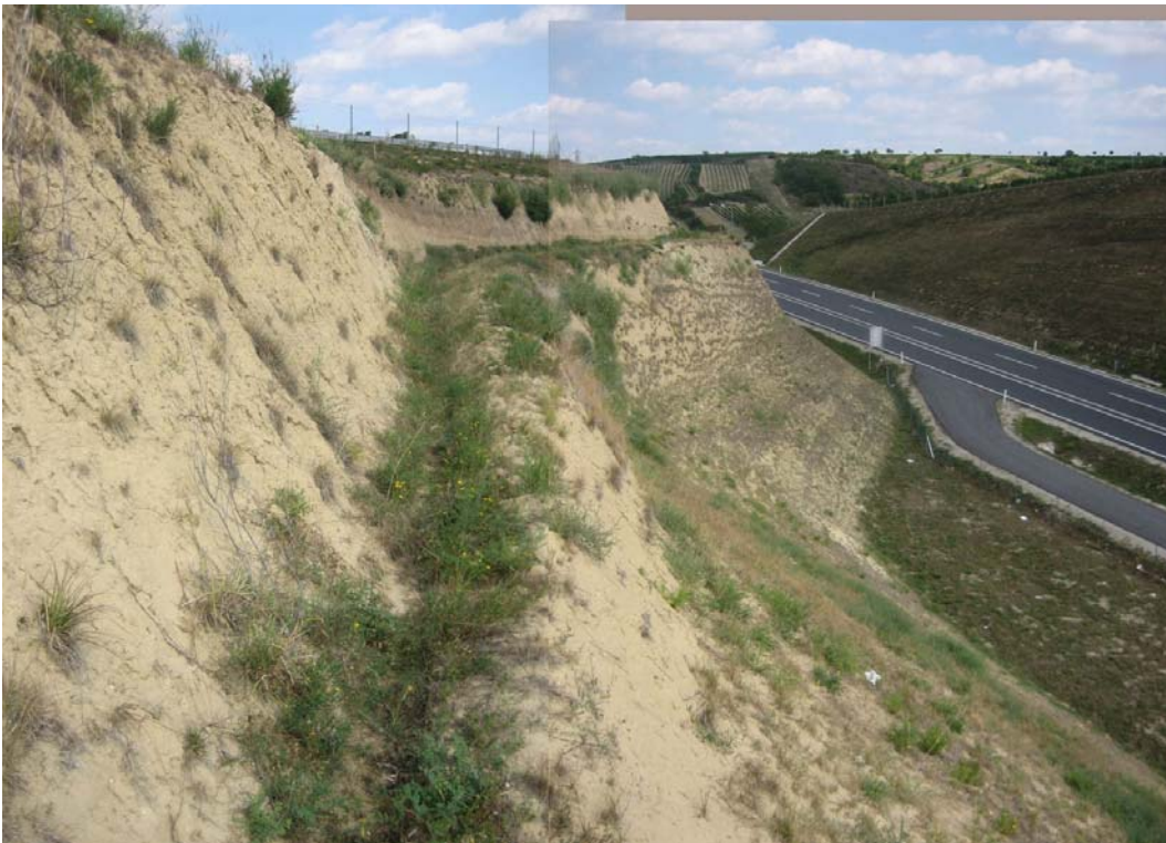
Abb. 59. (unten) S3-westl. Einschnittböschung, Abschnitt mit Berme und Lockersediment-Steilwänden 28.8.2007, Blick nach NNE
